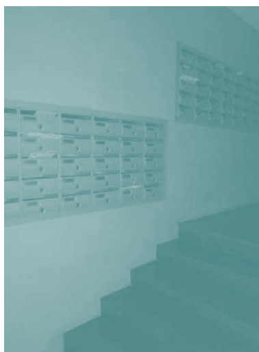
Buzones mal ubicados.
