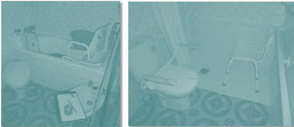
Cambio de bañera por ducha a ras de suelo como partida única.
